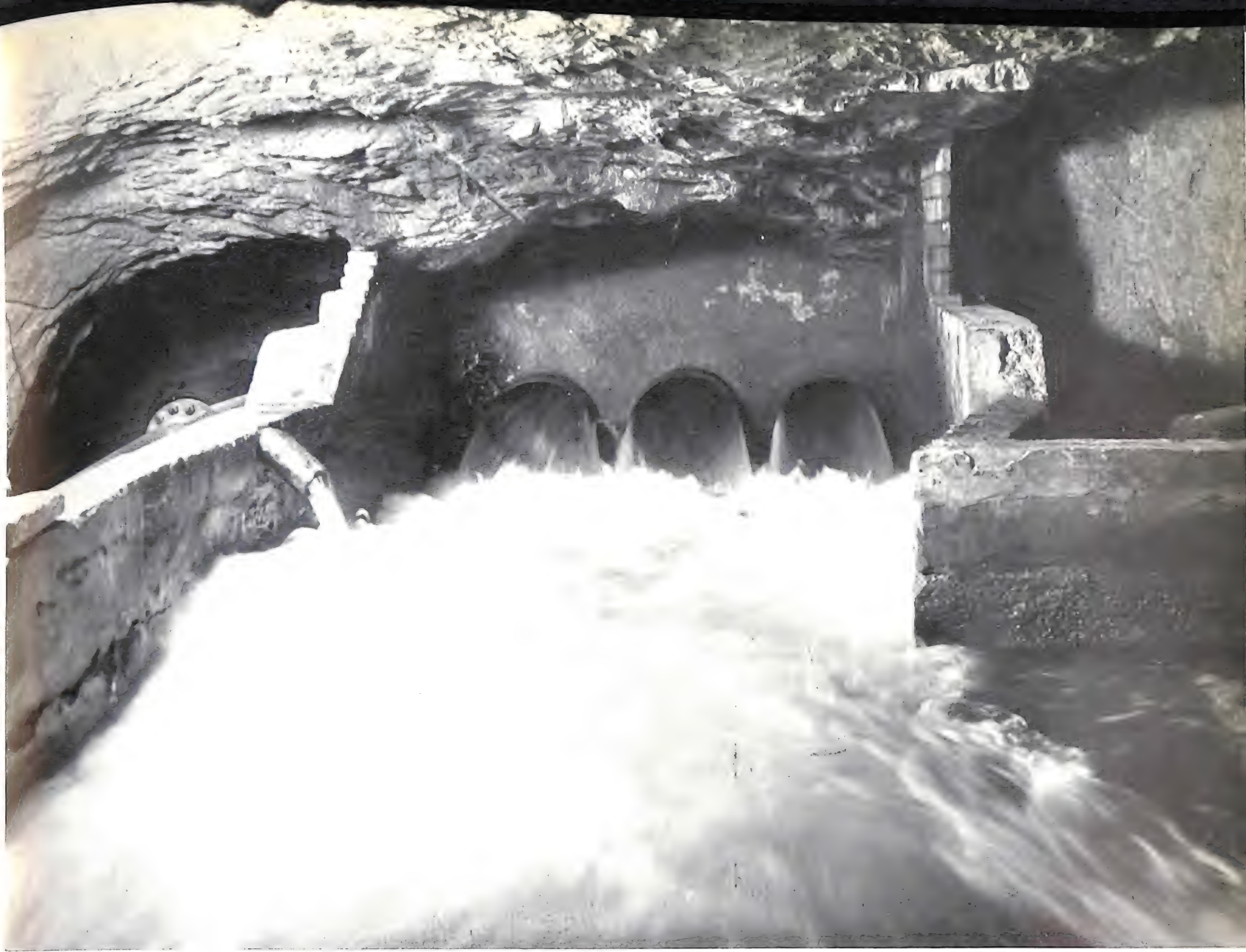
Monteponi - Lo scarico delle pompe del livello - 60 nel canale del livello - 13.
